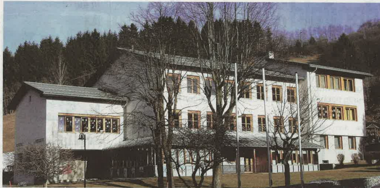
In der Volksschule entsteht Arriachs neues Biomasseheizwerk, das den halben Ort mit Fernwärme versorgen soll.
